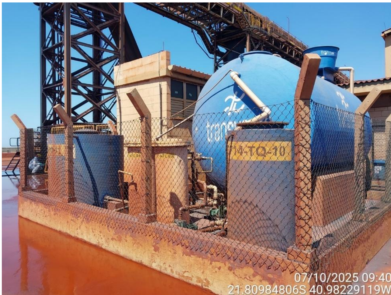
Figura 8 Estação de Tratamento de Resíduos Sanitários – Porto
