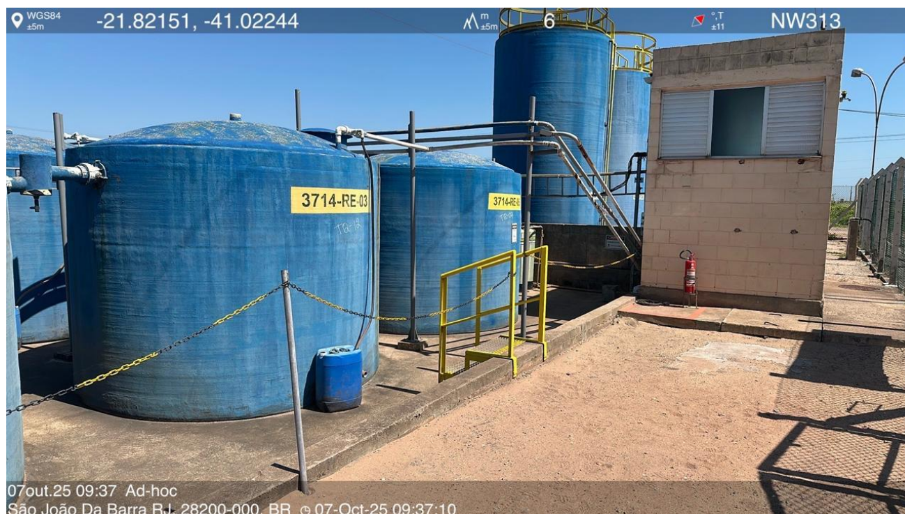
Figura 15 Vista parcial da tancagem da ETE
