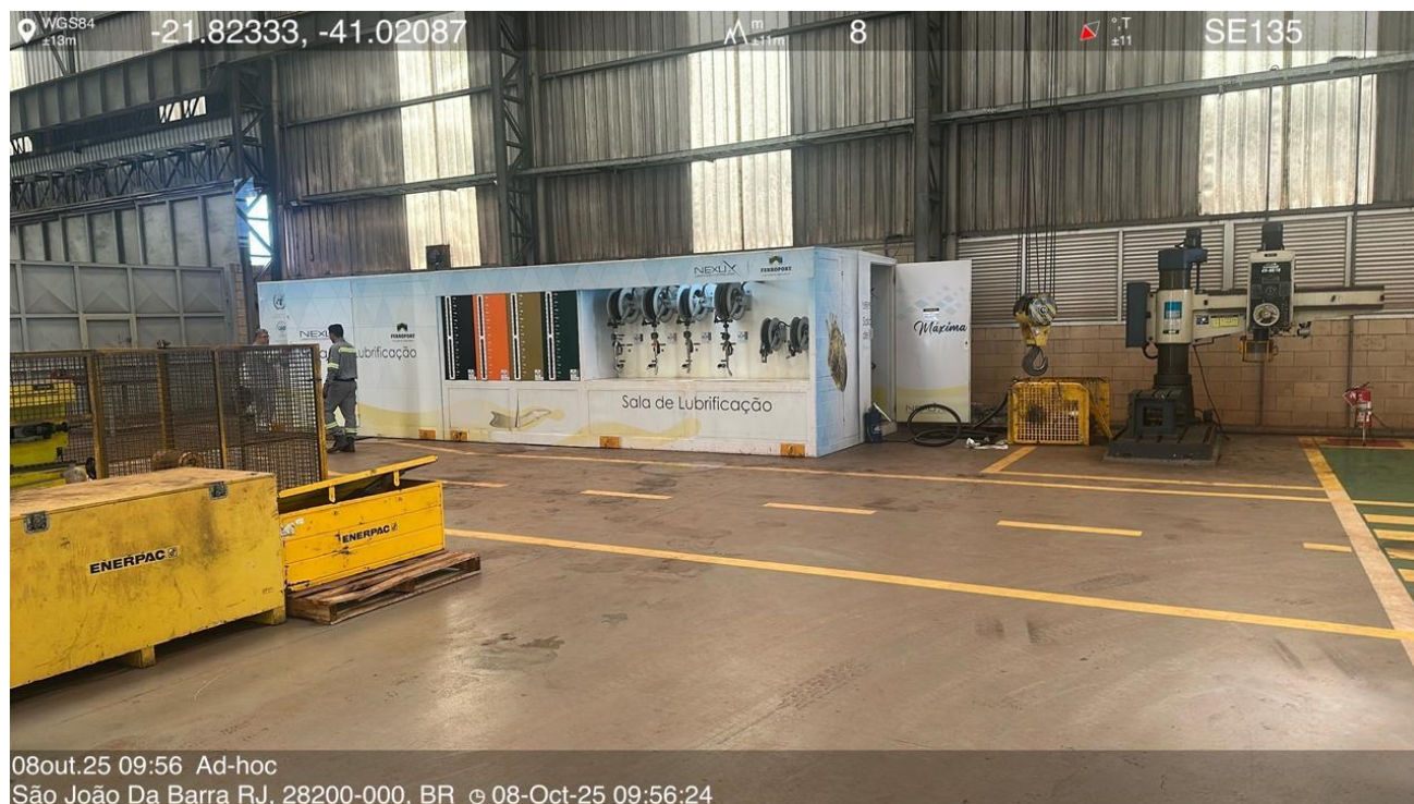
Figura 18 Sala de lubrificação
