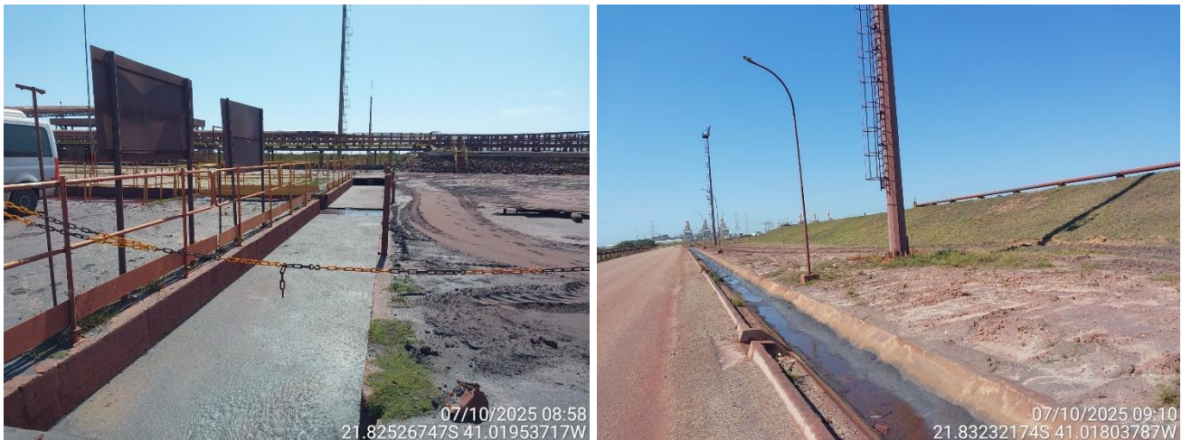
Figura 12 Sistema de drenagem do pátio de minério
