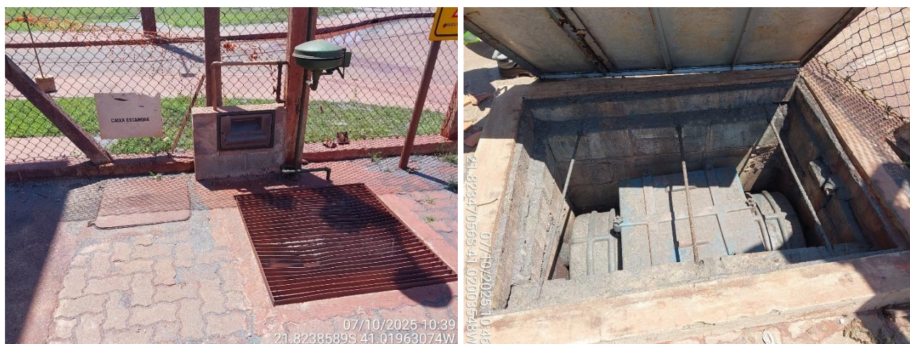
Figura 22 Caixa estanque e caixa separadora
