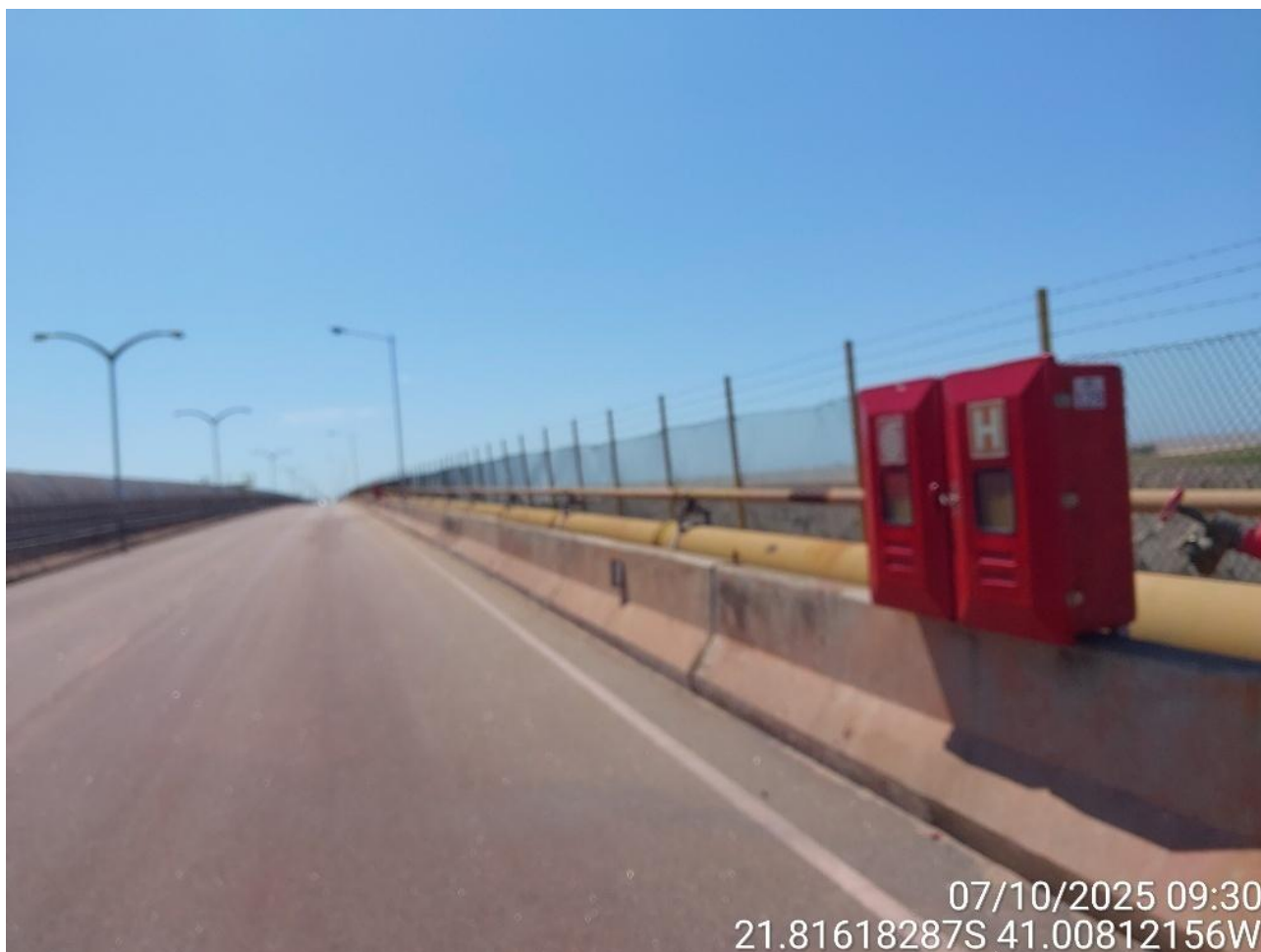
Figura 23 Exemplo de Rede de Hidrantes
