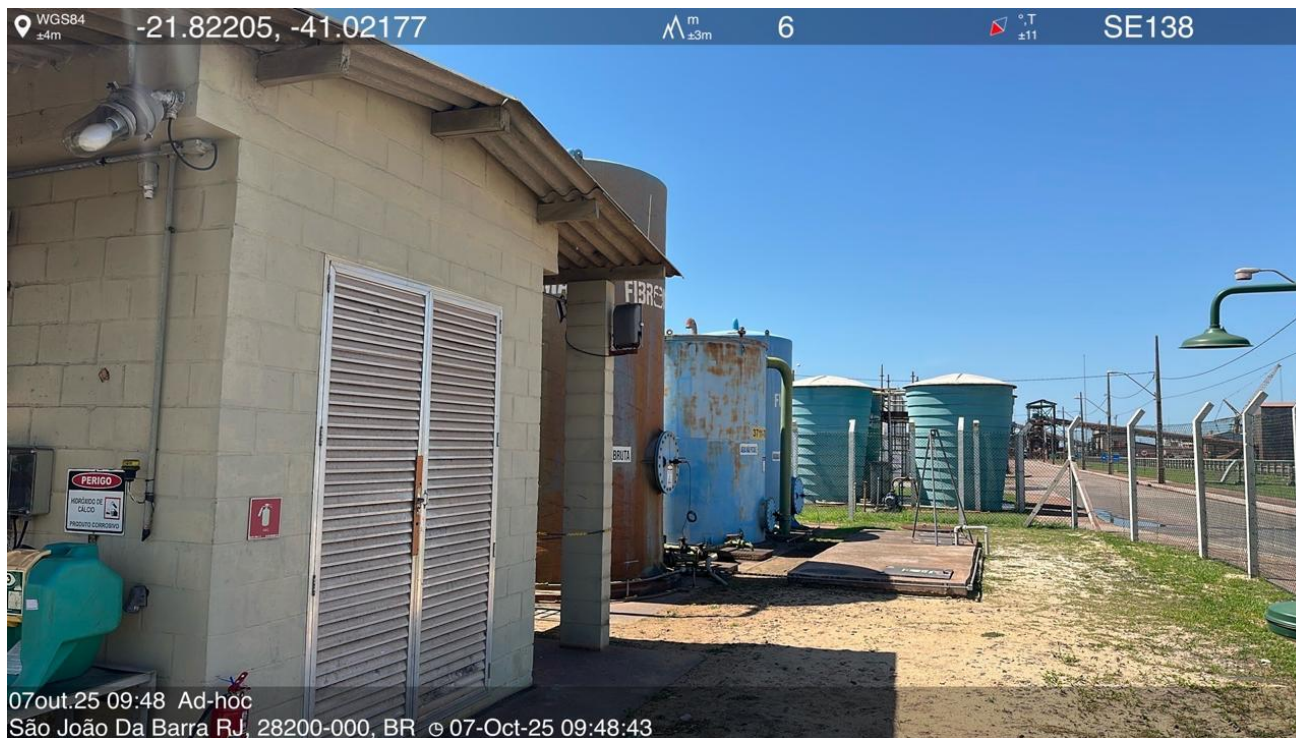
Figura 14 Visualização da tancagem da ETA
