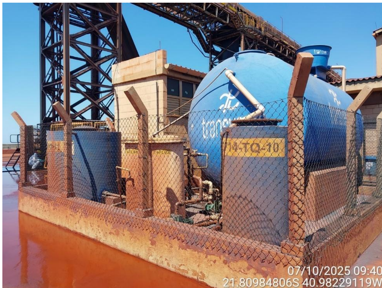
Figura 7 Estação de Tratamento de Resíduos Sanitários – Porto
