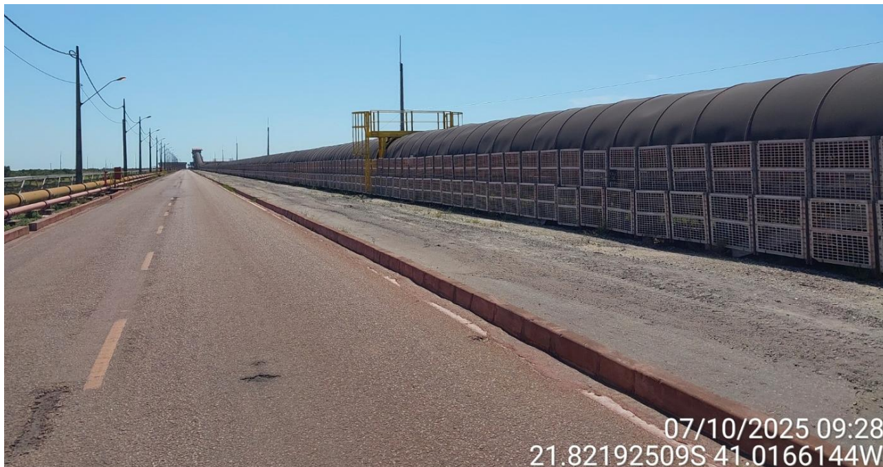
Figura 8 Proteção da Correia Transportadora
