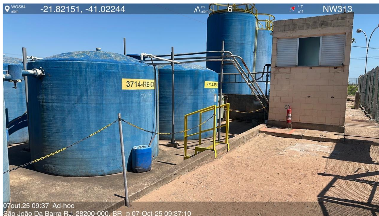
Figura 16 Vista parcial da tancagem da ETE
